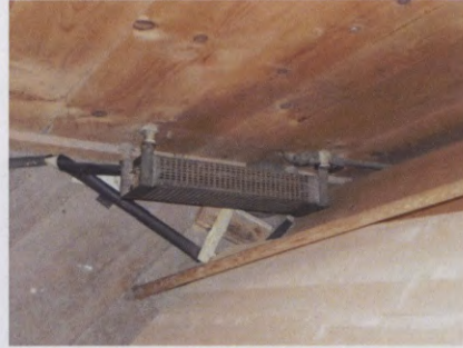
Heizkörper hinter Orgel
