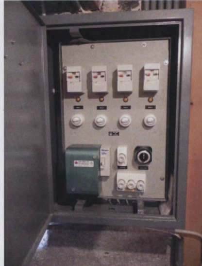
Elektr. Unterverteilung Turm
