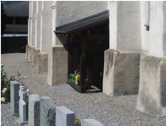
Sockel Südwestseite / Witterungsspuren
