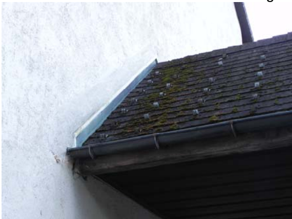
Vordach Nordwestseite / Moos
