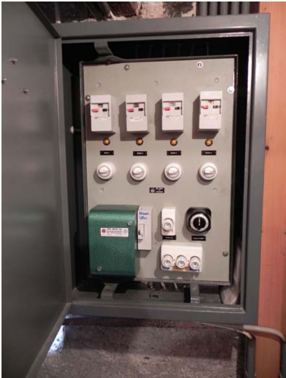
Elektr. Unterverteilung Turm
