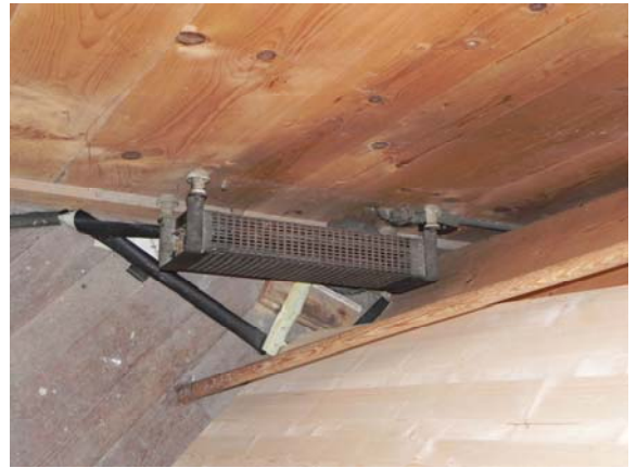
Heizkörper hinter Orgel
