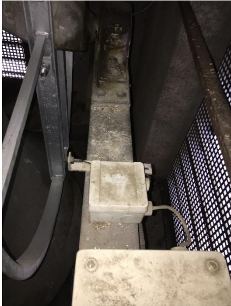
Glocke 1 mit Steuerschalter direkt auf Glockenstuhl
