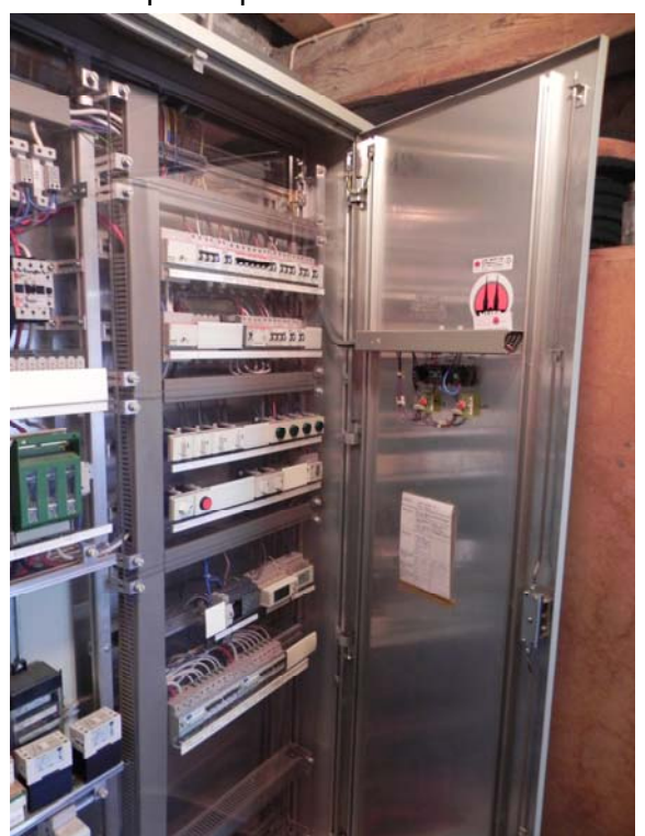
Steuerungsschrank Läutwerk / Uhr
