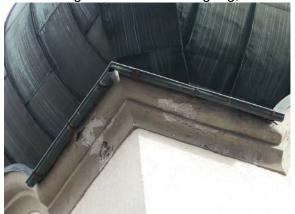
Schäden Dachrand Turm / Undichtigkeit
