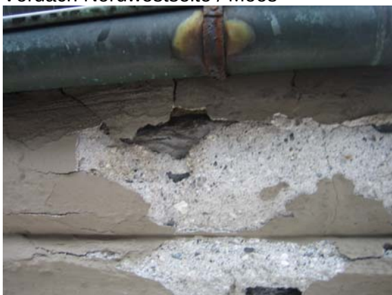
Verputzabplatzungen Dachrand Turm
