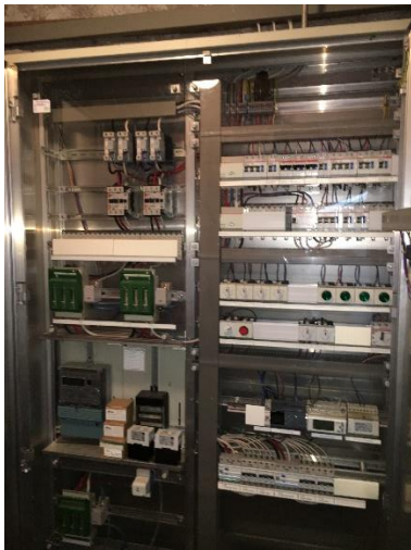
Hauptverteilung in aktueller Ausführung
