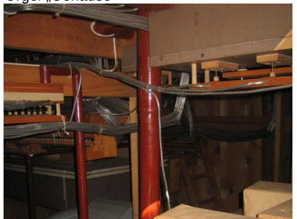
Unterbau Orgel / Leitungen
