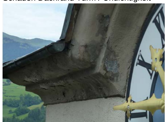
Schäden Dachrand Turm
