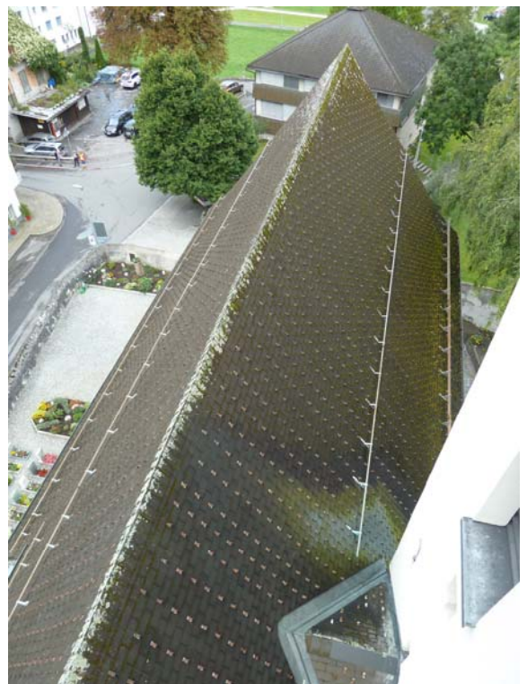
Eindeckung Schiff / Verunreinigung, Moos
