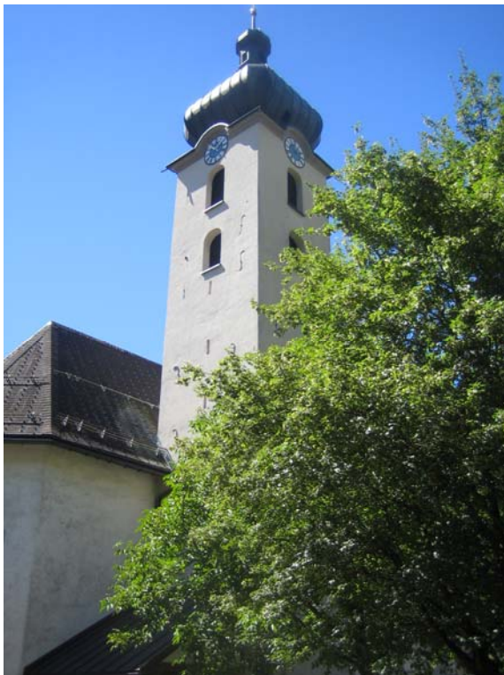
Turm Südostseite / Schäden Eindeckung
